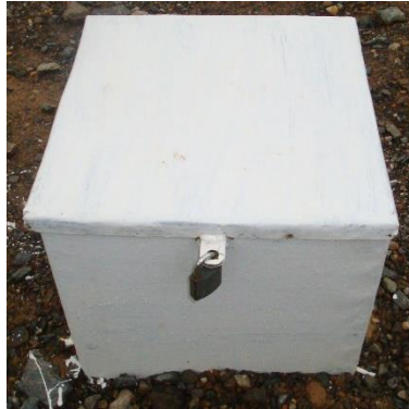
内部位移孔口保护装置实景图
